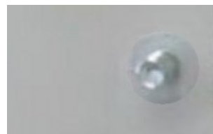
Abb. 20: Nicht gekennzeichneteter Erdungsbolzen
