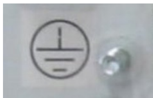
Abb. 19: Erdungsbolzen gekennzeichnet mit PE-Symbol
